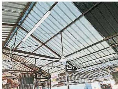
迪末巷小販中心破损的屋顶遮棚已修补, 同时也重新安装上风扇, 如此小販就能挥别燥热的空间。
