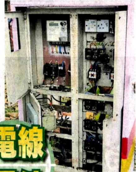
■电箱居然成为毛贼的目标,惨遭破坏。
